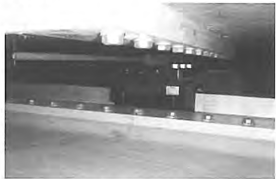
直動転がり支承8基
